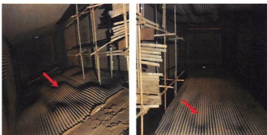
Gambar 1. Water wall tube boiler yang mengalami deformasi
